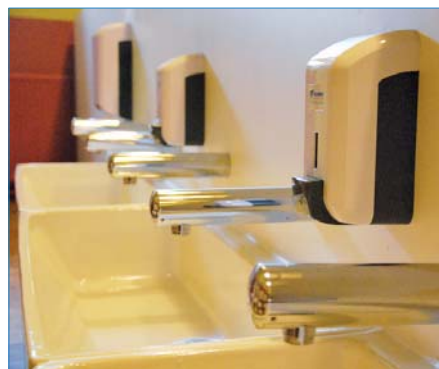
Les sanitaires ont été réaménagés à l'école Louise-Michel. Les robinets sont équipés de détecteurs automatiques.
